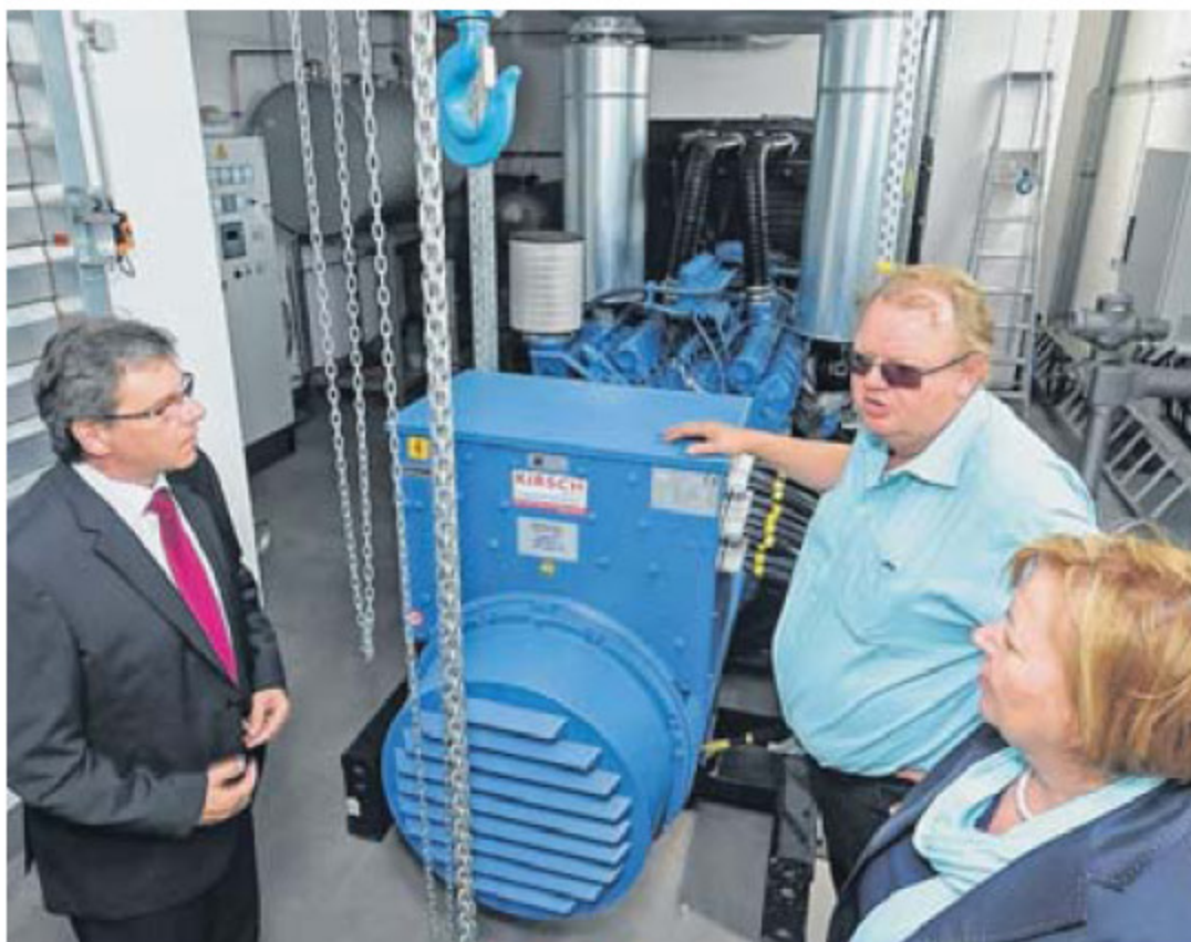
Umweltminister Frank Kupfer (l.) und CDU-Landtagsabgeordnete Ines Springer informierten sich gestern bei Betriebsteilleiter Ulrich Nürnberger über die Leistungsfähigkeit des Schöpfwerkes.
