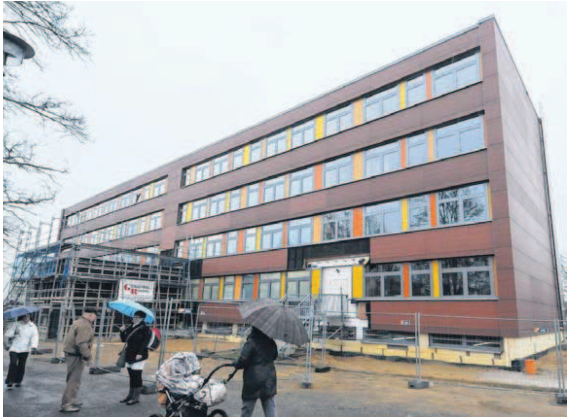
Die Sanierung der Sachsenallee-Schule in Glauchau lässt schon deutliche Fortschritte erkennen. Die Erneuerung von Sporthalle, Sportplatz und Schulhof wird erst in den kommenden Jahren folgen.
